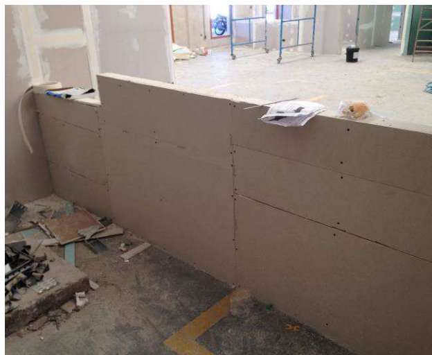
Figura 26C: Execução de base em gesso acartonado do balcão de atendimento da 5ª Vara do Trabalho.
