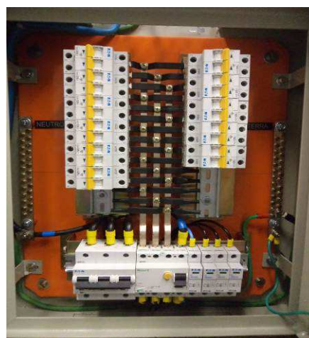
Figura 22E: quadro elétrico QD-AR 5VT
