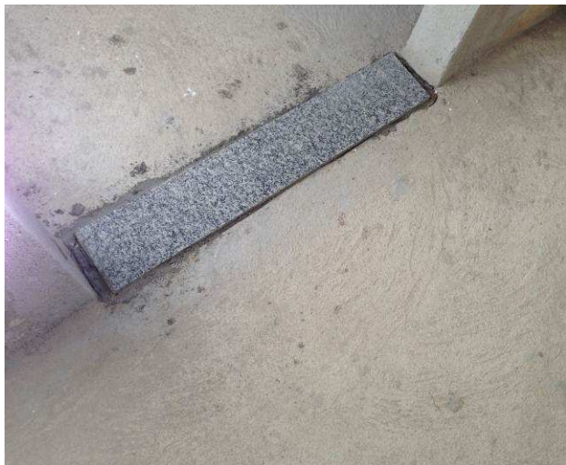
Figura 49C: Soleira em granito polido cinza andorinha instalada em entrada de vestiário da área de terceirizados.
