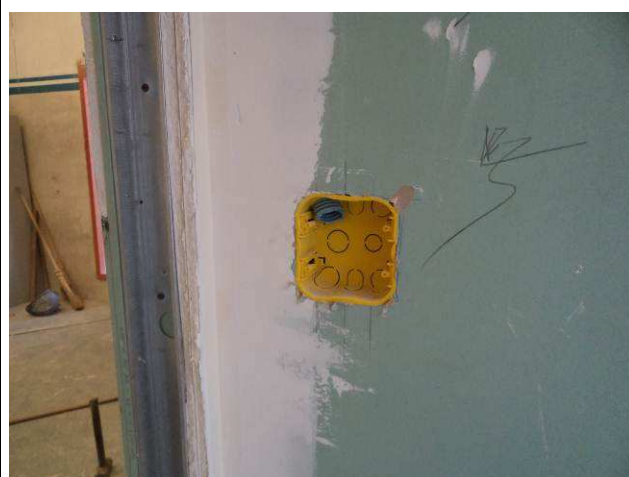
Figura 10E: caixas 4x4" iluminação - específicas para drywall – área barracão.
