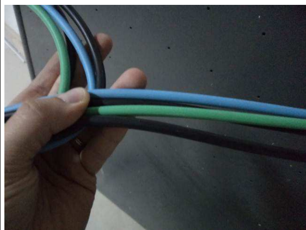
Figura 16E: ramal alimentador QD-guarita.
