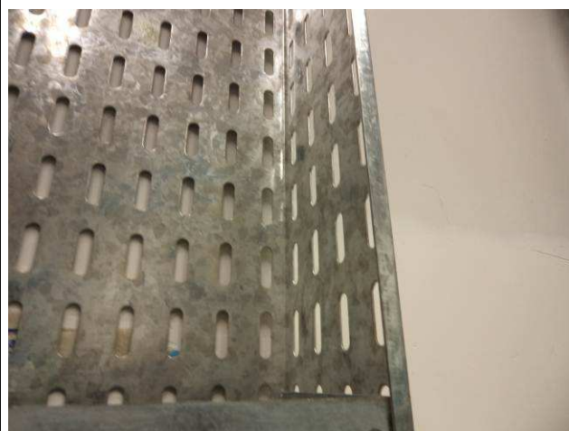
Figura 04E: eletrocalhas com virola – descida quadros sala técnica.
