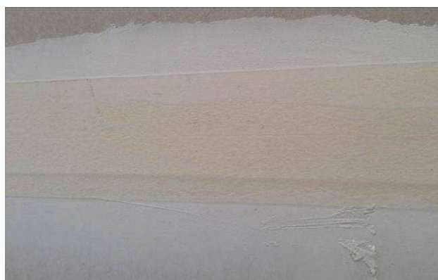
Figura 14C: Fita utilizada nas juntas das paredes em gesso acartonado ST-simples.
