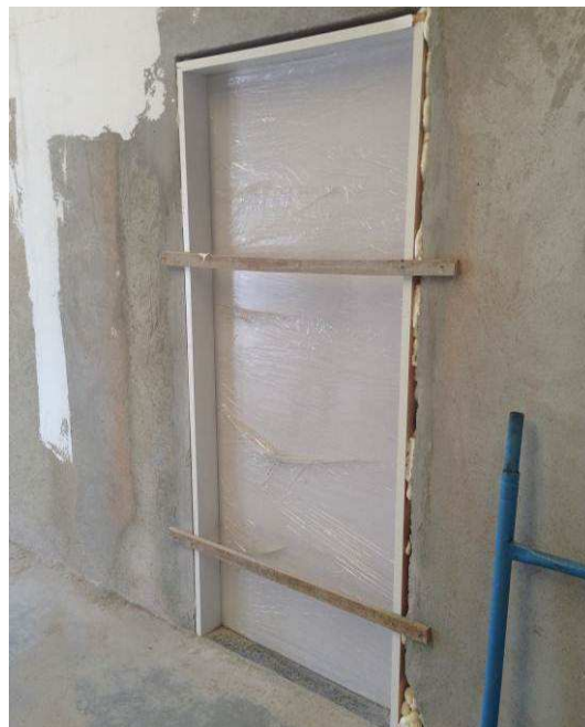
Figura 31C: Porta em madeira (PM80) com fundo primer branco, instalada em passagem do barracão novo para aquele ocupado.
