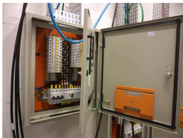
Figura 21E:quadro elétrico QD-AR 5VT
