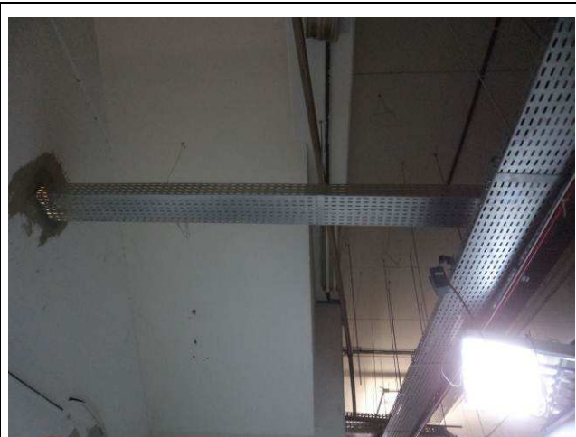
Figura 02E: eletrocalhas e acessórios sala técnica.
