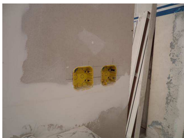
Figura 09E: caixas 4x4" iluminação - específicas para drywall – área barracão.
