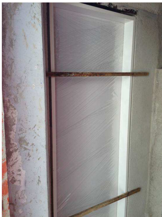
Figura 32C: Porta em madeira (PM80) com fundo primer branco, instalada na copa dos terceirizados.
