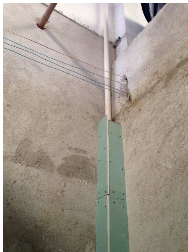
Figura 66C: Tubulação de ventilação do ramal principal de esgoto, embutida em "boneca" de gesso acartonado
