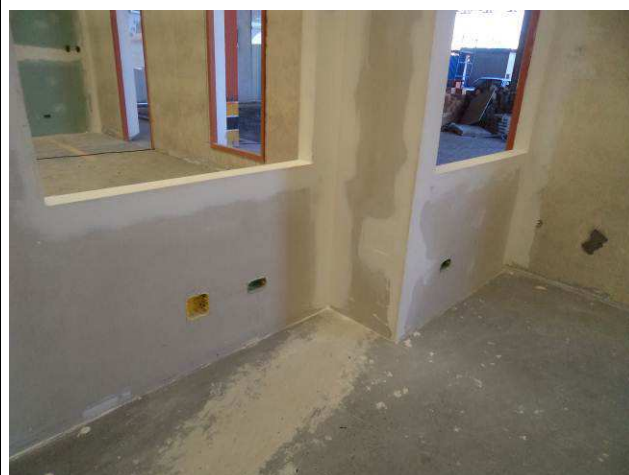
Figura 08E: caixas 2x4" e 4x4" – rede elétrica e cabeamento estruturado - específicas para drywall – área barracão.
