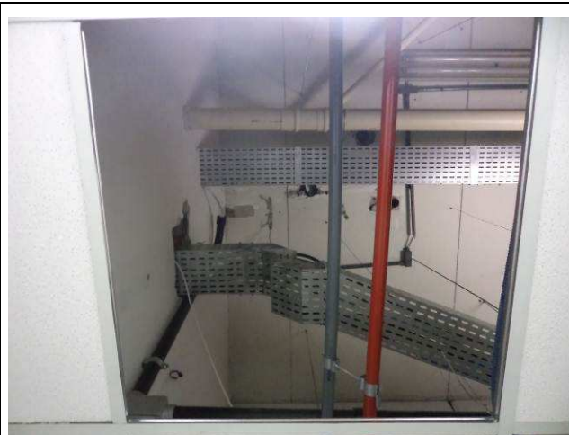
Figura 01E: eletrocalhas e acessórios sala técnica.
