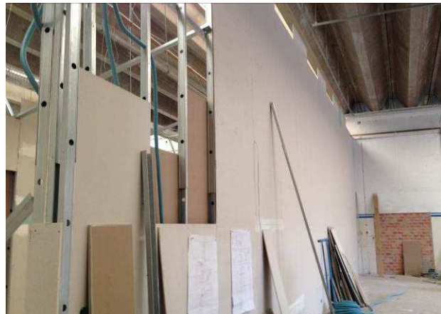
Figura 11C: Montagem de placas de gesso acartonado ST-simples, na circulação da 5ª Vara.
