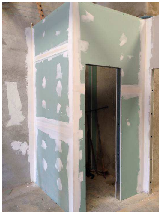
Figura 25C: Paredes em gesso acartonado RU (cor verde) em área em banheiro próximo à Direção do Fórum.
