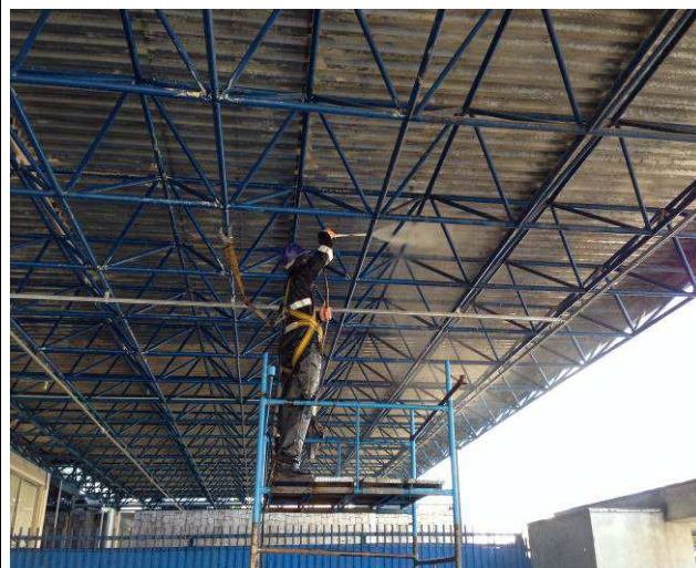
Figura 37C: Limpeza de estrutura metálica e face inferior de telhas com jato de alta pressão de água, em área de estacionamento coberto.
