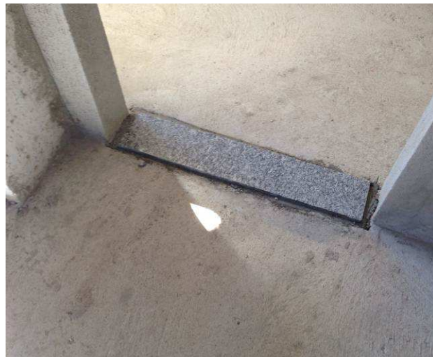
Figura 50C: Soleira em granito polido cinza andorinha instalada em entrada de vestiário da área de terceirizados.
