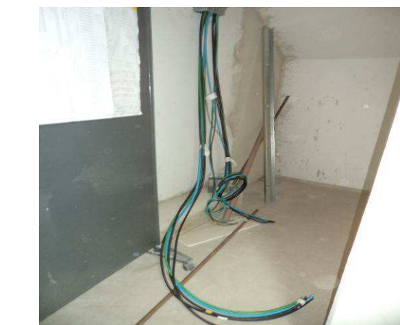
Figura 15E: cabeamento 0,6/1kV.- ramais alimentadores – local QDG
