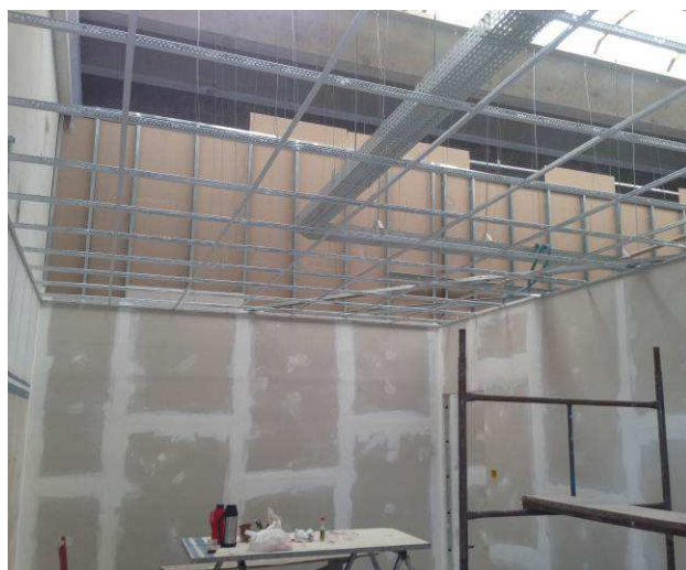
Figura 40C: Montagem dos perfis metálicos em área da 5ª Vara do Trabalho - sala de audiências.
