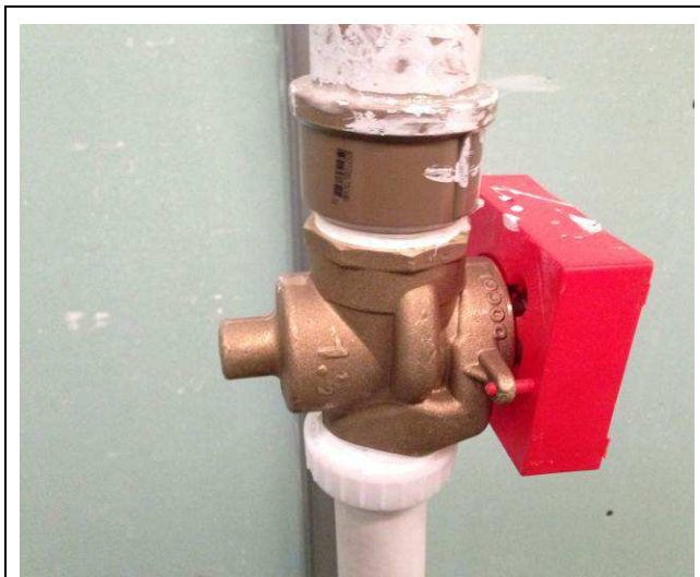
Figura 71C: Detalhe da base da válvula de descarga da marca Docol, em banheiro PNE da 5ª Vara do Trabalho.
