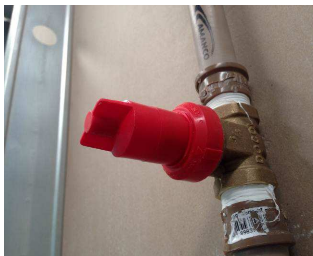
Figura 57C: Registro de gaveta 3/4" (Docol) em banheiro do barracão novo.
