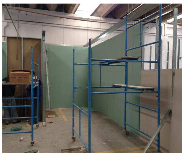
Figura 02C: Andaime para instalação de eletrocalhas e montagem de paredes em gesso acartonado.
