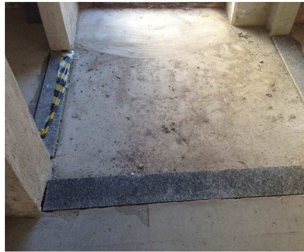
Figura 52C: Soleiras em granito polido cinza andorinha instaladas na entrada das áreas de copa, serviço e circulação da área de terceirizados.
