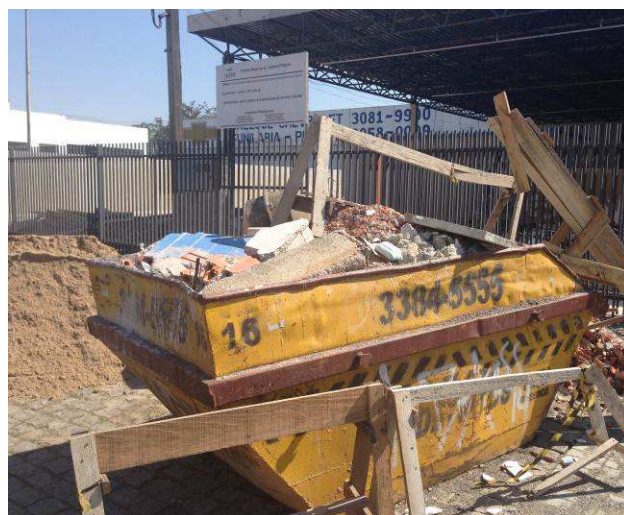
Figura 05C: Caçamba para coleta de entulhos.
