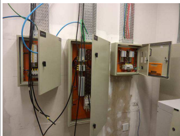
Figura 20E: quadros elétricos - sala técnica.
