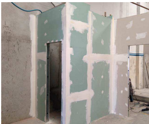
Figura 24C: Junção de paredes em gesso acartonado RU (cor verde) com paredes em gesso acartonado ST simples.
