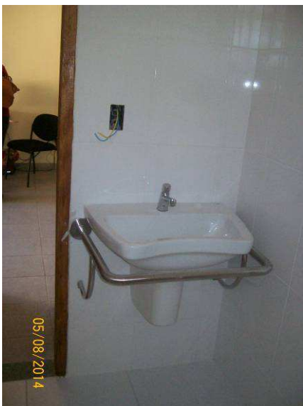
Figura 30: Lavatório com coluna suspensa, torneira de pressão e barra de apoio cromada para PNE Banheiro PNE da 1ª Vara.
