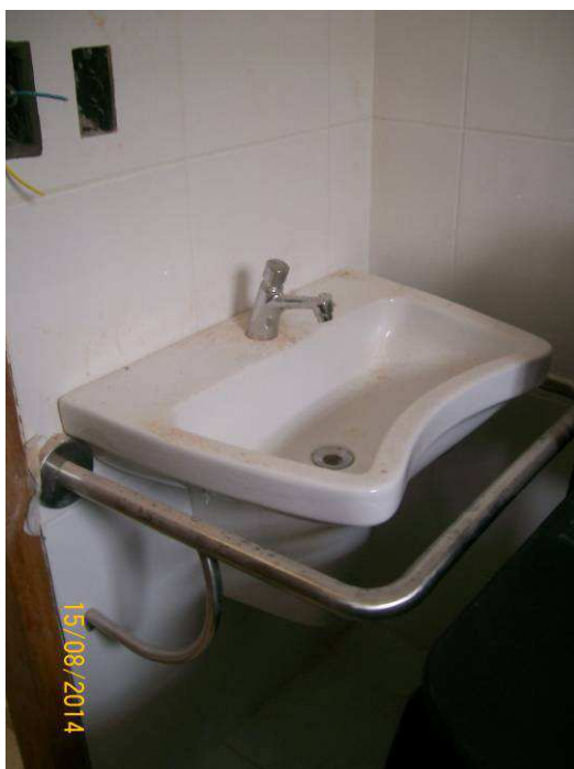
Figura 28: Ponto hidráulico lavatório novo da 1ª Vara.
