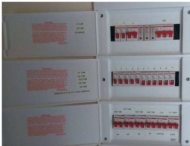
Figura 11E: Quadro elétrico
