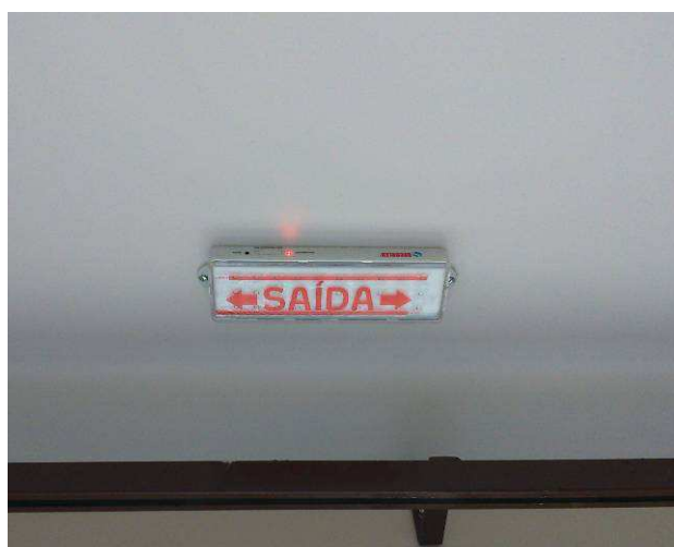
Figura 22E: Luminária de emergência
