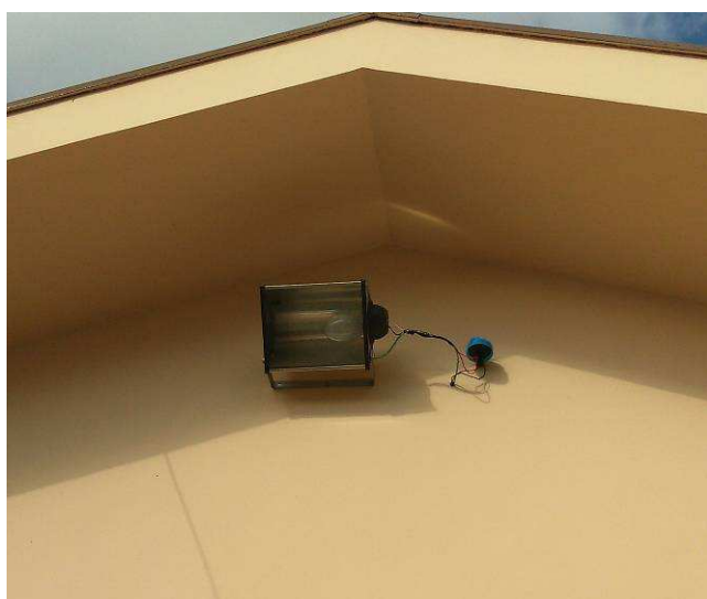
Figura 17E: Projetor de alumínio com relé fotoelétrico
