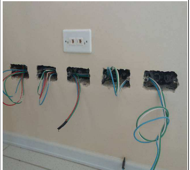
Figura 10E: Cabos instalados em caixa 2x4"
