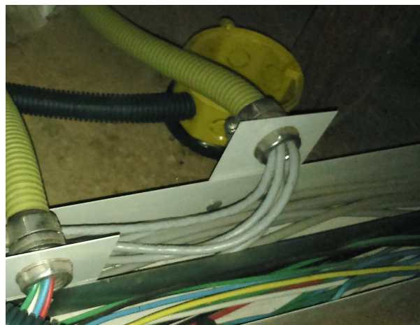
Figura 24E: Cabo UTP cat 6 em eletrocalha
