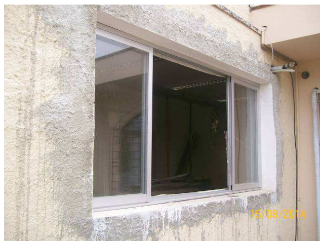
Figura 20: Janela em alumínio para Sala de Audiência da 2º Vara.
