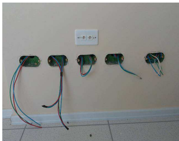
Figura 02E: Caixas de PVC – drywall/alvenaria
