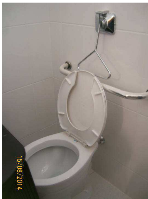
Figura 29: Ponto hidráulico vaso novo da 1ª Vara.
