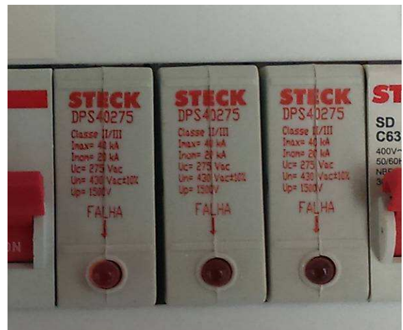
Figura 12E: DPS- dispositivo de proteção contra surtos.
