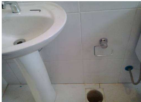
Figura 41: Lavatório com coluna, torneira de pressão e papelera metálica. Banheiro do gabinete.
