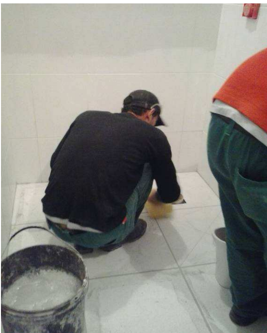
Figura 15: Execução de regularização de parede e colocação de azulejos e piso. I.S PNE
