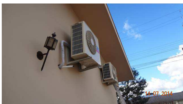
Figura 35: Dreno ar condicionado. Parede lateral.
