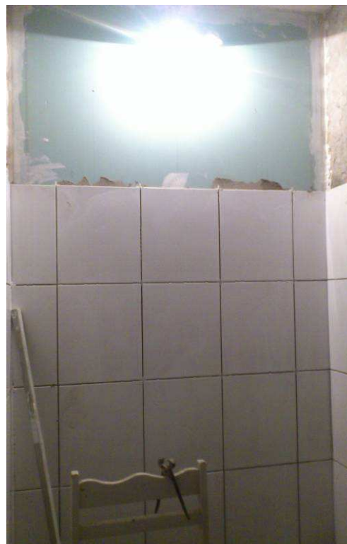
Figura 10: Fechamento com gesso acartonado verde, na divisa dos banheiros.
