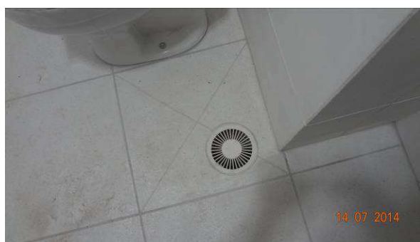
Figura 34: Caixa sifonada instalada banheiro PNE
