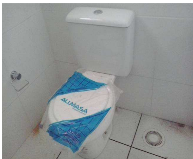
Figura 37: Vaso sanitário com caixa acoplada e papeleira metálica. Banheiro servidores.
