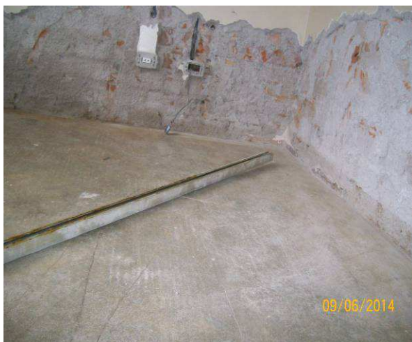
Figura 05: Remoção do assoalho de madeira e revestimento de argamassa em parede a 80 cm de altura para impermeabilização.
