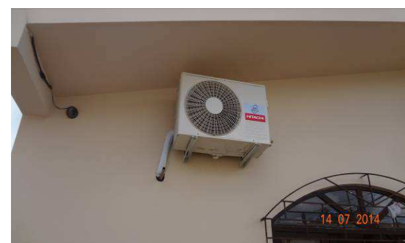
Figura 36: Dreno ar condicionado. Parede lateral.
