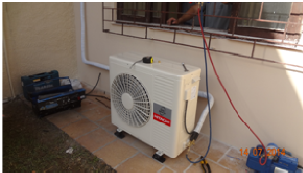
Figura 43: Instalação de aparelho externo de ar condicionado, no gabinete do juiz.
