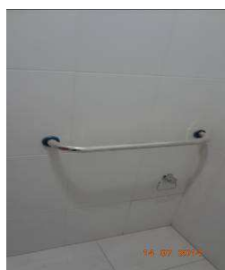
Figura 39: Vaso sanitário para PNE e barras de apoio cromadas.
