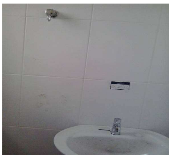
Figura 22: Ponto hidráulico lavatório novo
