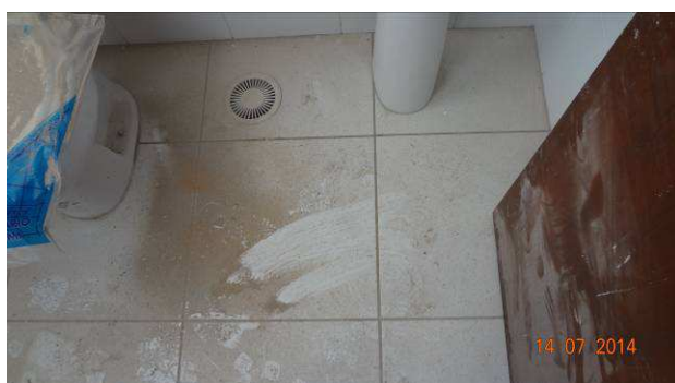
Figura 33: Caixa sifonada instalada banheiro servidores.
