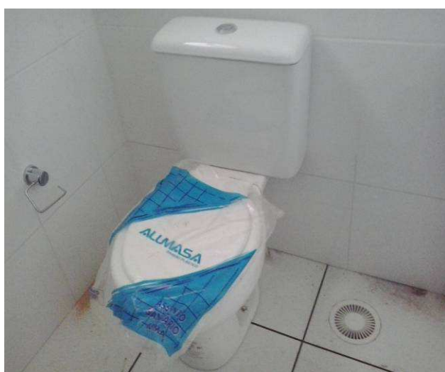
Figura 21: Ponto hidráulico vaso novo.
