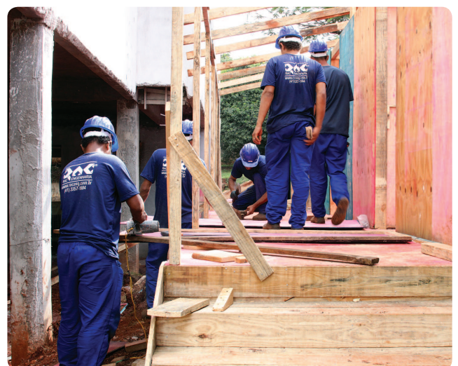
Os operários reconstruíram as instalações de apoio, na retomada da obra, paralisada por falhas na execução
