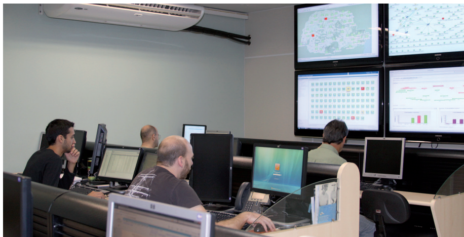
Nova sala Network Operation Center, na Avenida Vicente Machado, 400 (1º andar)
