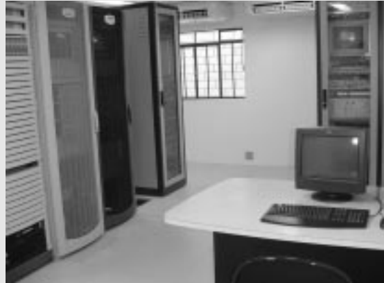
O Datacenter deve receber investimentos em processamento, infra-estrutura e climatização
